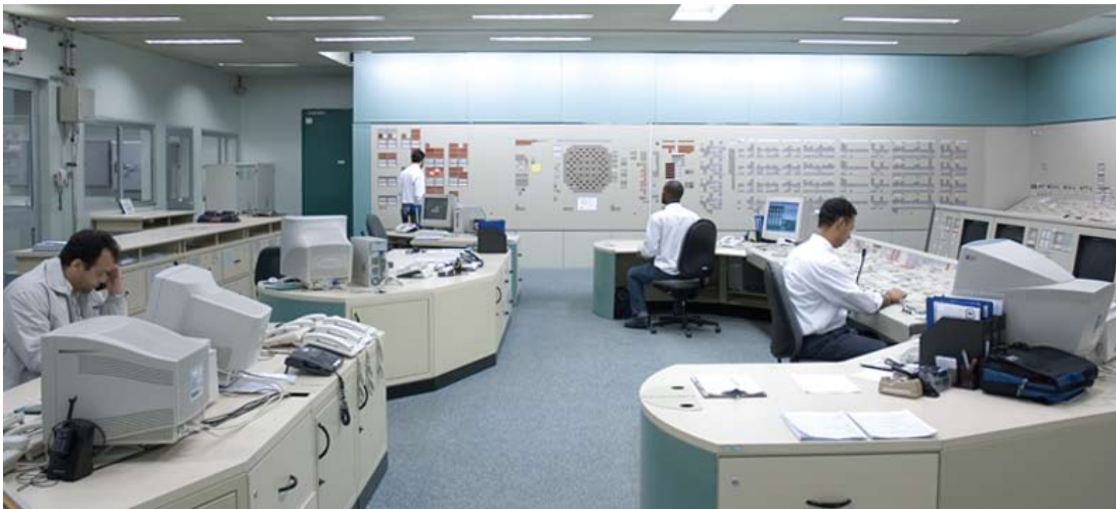
Sala de controle - Central de operação.
